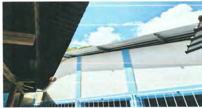
Foto 2: sustitucion de canal, entechado y estructura en corredor de la cocina.
