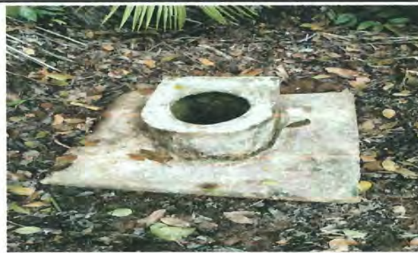
Foto 2: Servicios de sanitarios y accesorios.
